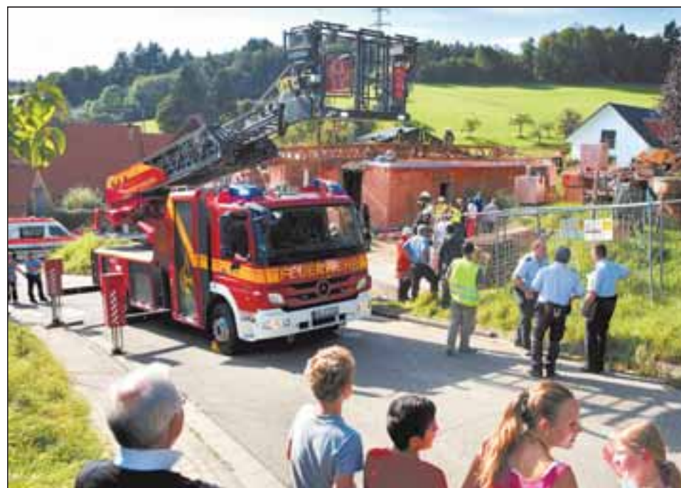
Drei Verletzte, zwei davon schwer, und ein beschädigter Rohbau sind das Ergebnis von Bauarbeiten in Leimen-Lingental, bei denen gestern Nachmittag ein Baukran abknickte. Foto: Alex
