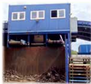
Be- & Entlüftung von Sortierkabinen
